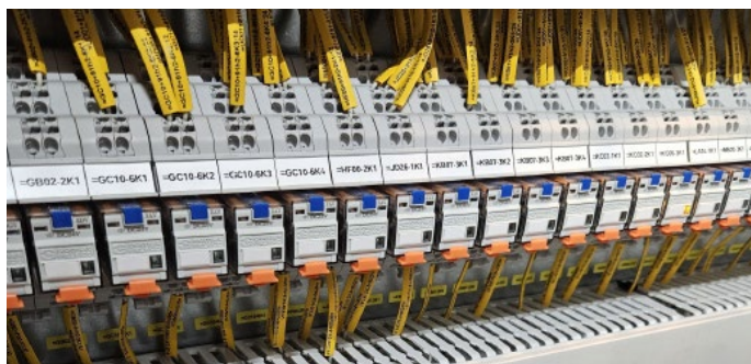
Base para relé S7-PIR instalada en un cuadro eléctrico de Windhoff
