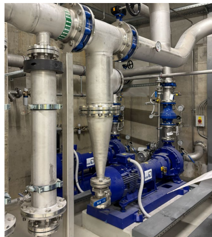
Pumpen, Schieber und Armaturen werden über elektrische Stellantriebe automatisiert angesteuert
