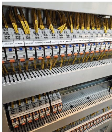
S7-PIR-Sockel im Windhoff-Schaltschrank – reale Verdrahtung im Einsatz
