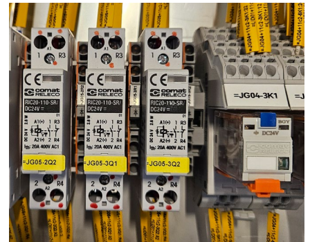
RIC-Bahnschütz zur Ansteuerung von Motorsteuerrelais für verschiedene Anwendungen
