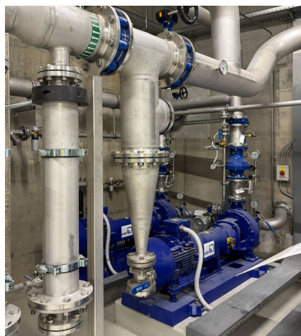
Las bombas, las válvulas de compuerta y los accesorios se controlan de forma automatizada mediante actuadores eléctricos.
