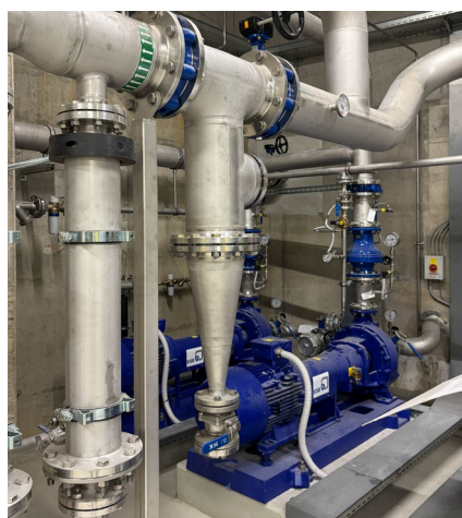
Les pompes, vannes et clapets sont pilotés automatiquement au moyen d'actionneurs électriques.
