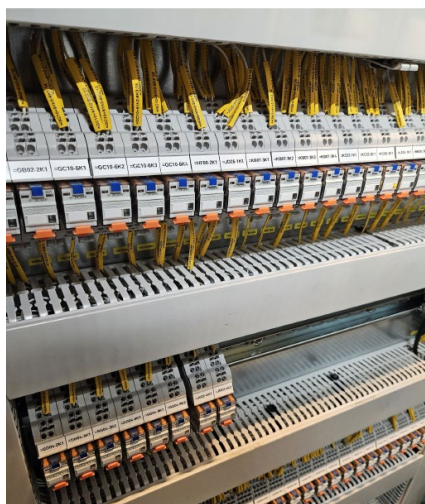
Socle S7-PIR dans l'armoire électrique Windhoff – câblage réel en service
