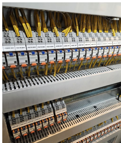
Prese S7-PIR nell'armadio elettrico Windhoff – cablaggio reale in funzione
