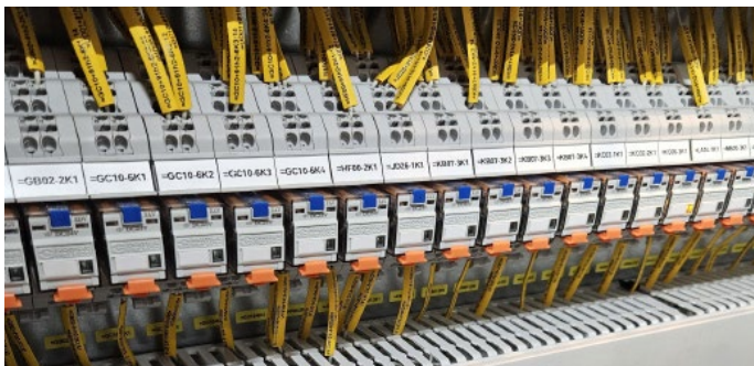
S7-PIR-Sockel im Windhoff-Schaltschrank – reale Verdrahtung im Einsatz
