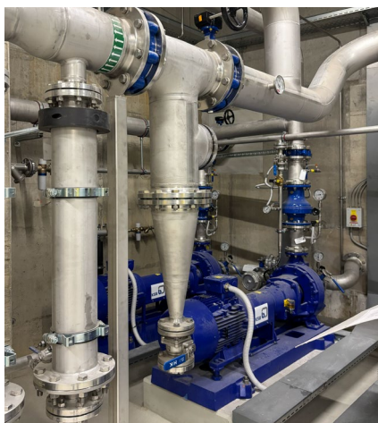
Le pompe, le paratoie e le valvole sono comandate automaticamente tramite attuatori elettrici.
