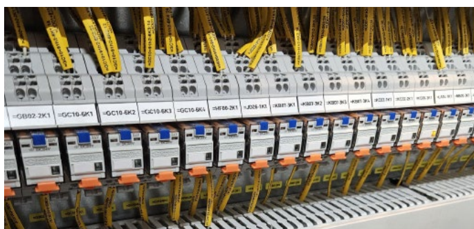
Prese S7-PIR nell'armadio elettrico Windhoff – cablaggio reale in funzione
