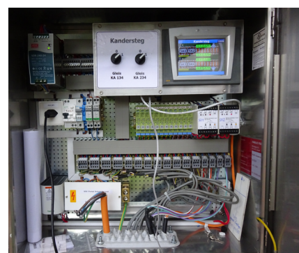
PLC, relais temporisés et contacteurs d'installation. Photos © BLS SA / M. René Fischer
