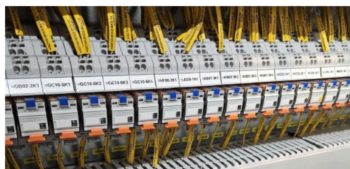
Socle S7-PIR dans l'armoire électrique Windhoff – câblage réel en service
